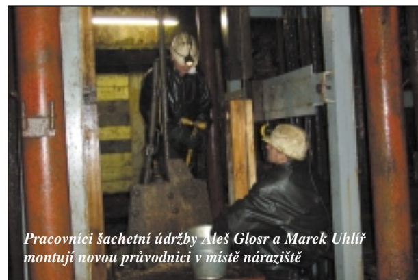
Pracovníci šachetní údržby Zdeněk Černý a mistr Roman Jílek při usazování dvojice stropních stykových nosníků
