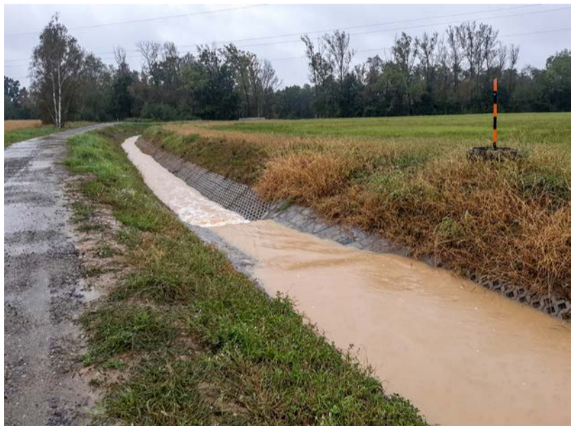
Systém odvodnění odkaliště obstál v ostré zkoušce
