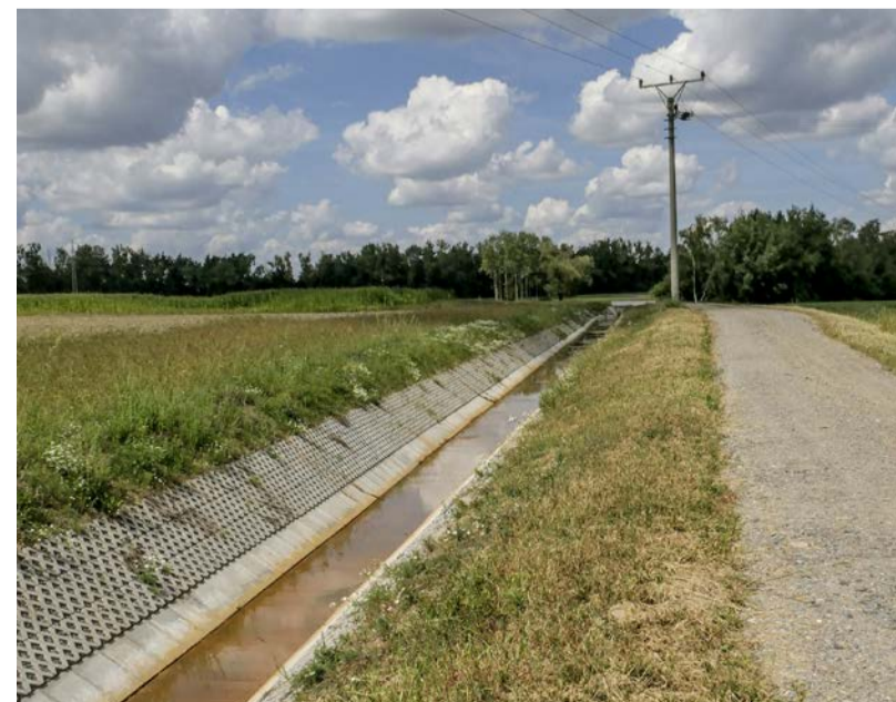
Odvodňovací kanál v Mydlovarech
