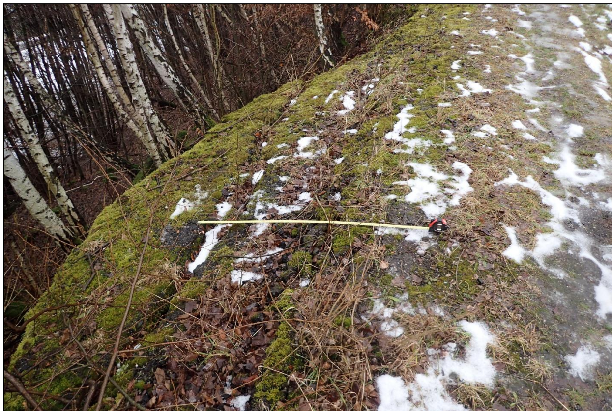
Obrázek č. 10 – SD 6 – Poškozená krajnice polní cesty
