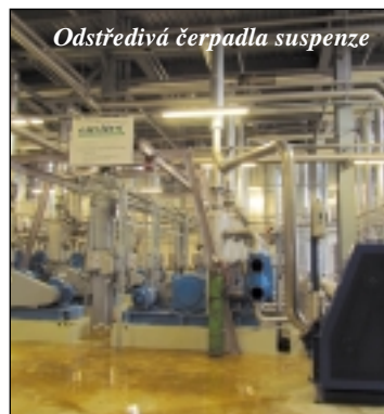
Hala filtrace s kalolisy
