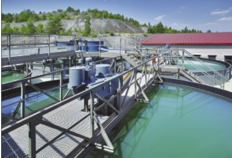
Čisticí stanice důlních vod Příbram II, o. z. SUL Příbram
